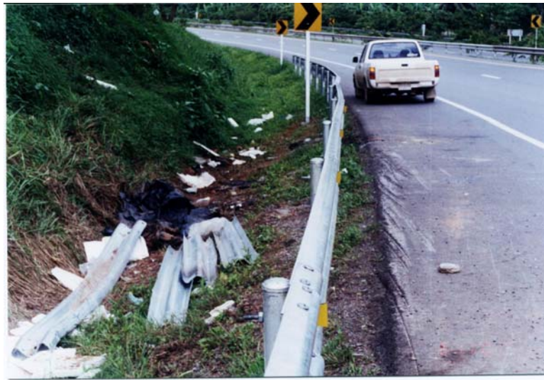
ภาพประกอบ 5.17 สภาพราวกันตกที่นำมาติดตั้งหลังจากอุบัติเหตุของรถโดยสารและรถจักรยานยนต์เสียหาย กม.14+200 ทางหลวงหมายเลข 41 ตอน อ.ทุ่งสง – จ.พัทลุง อ.ร่อนพิบูลย์ จ.นครศรีธรรมราช
