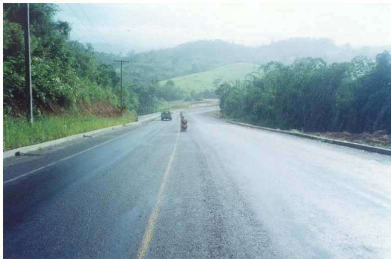
ภาพประกอบ 5.2 ลักษณะทางกายของถนนบริเวณ กม.65+000-67+000 ทางหลวงหมายเลข 323 ตอน ห้วยรันตีร์ย์-ด่านเจดีย์ อ.สังขละบุรี จ.กาญจนบุรี
