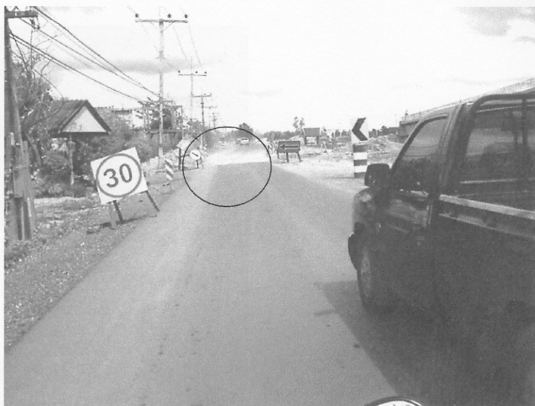
ภาพประกอบ 4.23 พื้นผิวทางที่มีการขุดเพื่อการก่อสร้างแล้วไม่ได้ซ่อมแซมให้เหมือนเดิมอาจเป็นอันตรายต่อผู้ใช้รถใช้ถนนหากขับรถมาด้วยความเร็วสูงอาจเสียการควบคุมรถได้
