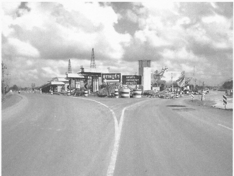
ภาพประกอบ 4.8 บริเวณทางแยกที่มีการจัดช่องจราจรใหม่คนขับไม่สามารถมองเห็นได้ชัดในระยะทางที่เพียงพอ โดยเฉพาะคนขับที่ไม่เคยผ่านเส้นทางมาก่อน (กลางวัน) (กม. 6+900)
