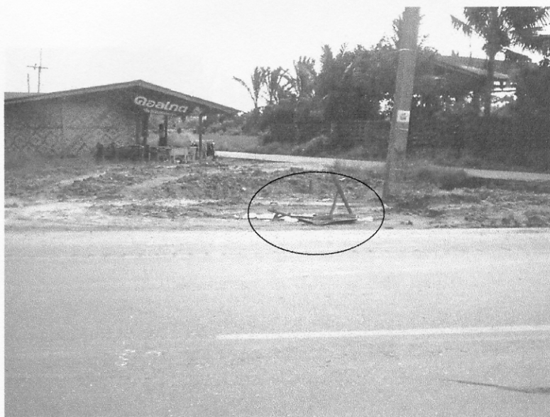
ภาพประกอบ 4.16 ป้ายจราจรซึ่งติดตั้งไว้ไม่แข็งแรงเท่าที่ควรอาจสร้างอันตรายแก่ผู้ใช้เส้นทางได้
