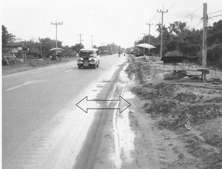
ภาพประกอบ 4.4 ดินถมบริเวณข้างทางหลังจากฝนตกหล่นลงมาบนพื้นผิวทางทำให้ความกว้างของ ช่องจราจรแคบลงเป็นช่วงๆ ทำให้ขาดความต่อเนื่องในการขับขี่ และอาจเสียหลัก ถื่นล้มได้โดยเฉพาะรถจักรยานยนต์ (ช่วง กม. 13+300-15+700)
