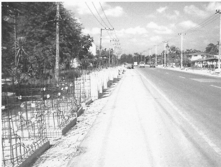
ภาพประกอบ 4.21 สิ่งก่อสร้างข้างทางที่ไม่มีอุปกรณ์ป้องกัน อาจสร้างอันตรายต่อผู้ใช้เส้นทางสัญจร หากเสียหลักเข้าไปชนได้ (กม. 26+000)
