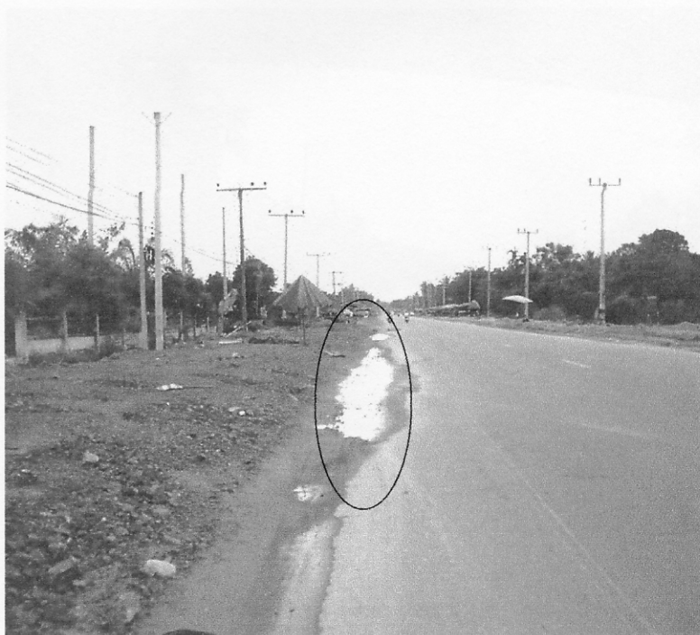
ภาพประกอบ 4.22 บริเวณไหล่ทางที่มีน้ำขัง และดินถมปกคลุมสร้างปัญหาในการใช้เส้นทางโดยเฉพาะรถจักรยานยนต์ ซึ่งต้องหลบหลีกอาจเฉี่ยวชนกับรถจากช่องทางจราจรหลักได้
