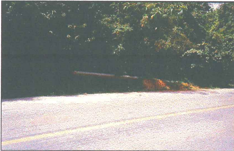
ภาพประกอบ 11 สภาพแวดล้อมข้างทางที่มีโอกาสเกิดอุบัติเหตุได้ เนื่องจากการวางเสาไฟฟ้าไว้บริเวณข้างทาง ซึ่งเป็นการวางที่ไม่ถูกต้องและไม่ปลอดภัยต่อผู้ขับขี่รถยนต์
