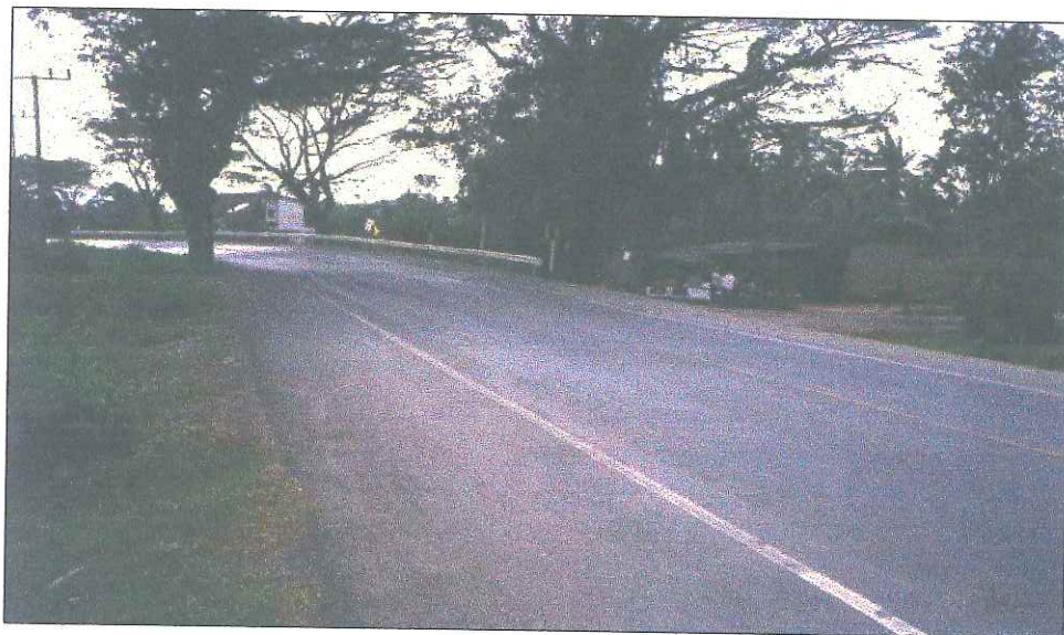
ภาพประกอบ 5.5 บริเวณ กม. 03+500 ทางหลวงหมายเลข 406 ทางโค้งบริเวณชุมชนและมีทางเชื่อมบริเวณทางโค้งประกอบด้วยมีระยะการมองเห็นที่ไม่เพียงพอ
