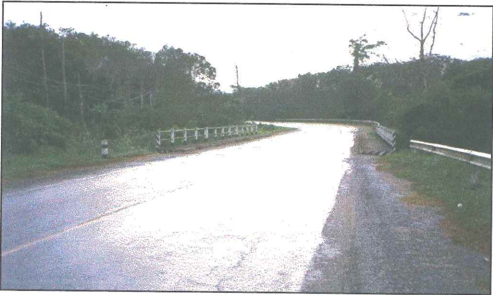
ภาพประกอบ 6.1 ตัวอย่างของการติดตั้งราวกันตกที่ไม่เหมาะสมและสภาพราวที่ไม่ดี ซึ่งเป็นเหตุให้ได้รับอันตรายได้ (ทางหลวงหมายเลข 42 บริเวณ กม. 42+500)
