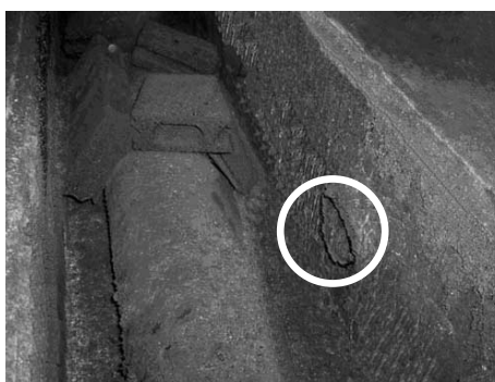
ภาพที่ 3 ท่อควันในร่องขนาด 1 \times 1 เมตร ที่พื้นห้องรม และรูขนาด 4 นิ้ว (ในวงกลม)
