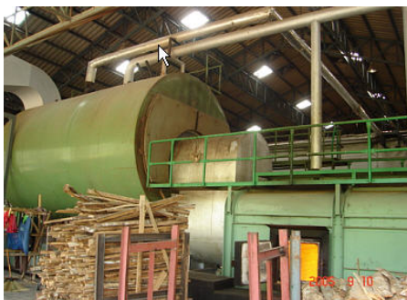
ภาพประกอบที่ 4.30 แหล่งกำเนิดพลังงาน หม้อต้มน้ำที่ใช้เศษไม้ยางพาราและจี้เลื่อยเป็นวัตถุดิบ
