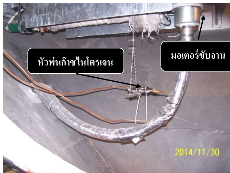
รูปที่ 3.13 ตำแหน่งที่ติดตั้งหัวฟันท้าชไนโตรเจน บริเวณใต้มอเตอร์ที่อยู่ภายในถังอะตอมไมเซอร์
