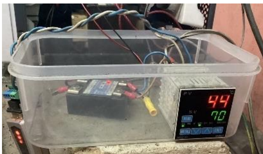
รูปที่ 3.16 ระบบควบคุมความร้อนเตาปฏิกรณ์ไมโครเวฟไพโรไลซิส
