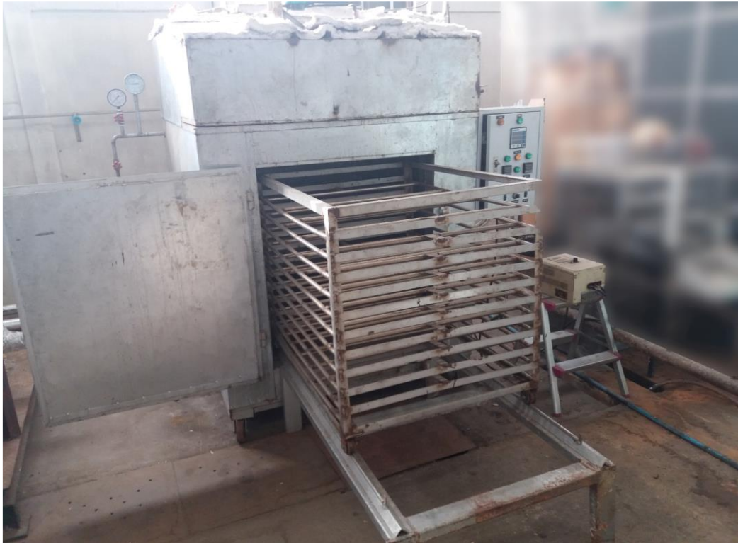
Fig. 2-3 Actual equipment setup.
