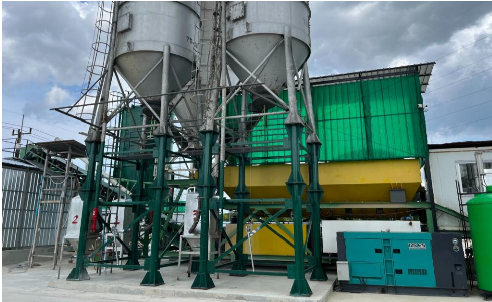
ภาพที่ 4.21 โรงงานผลิตคอนกรีตผสมเสร็จ
