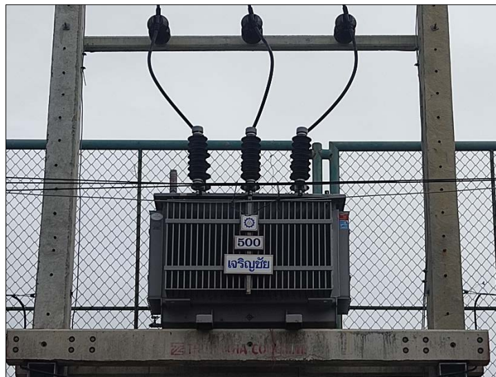
ภาพประกอบ 1-1 หม้อแปลงไฟฟ้า
