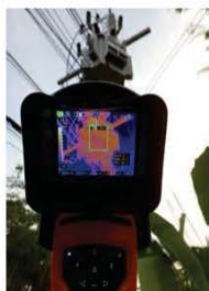
รูปที่ 2 การวัดค่าอุณหภูมิของหม้อแปลง
