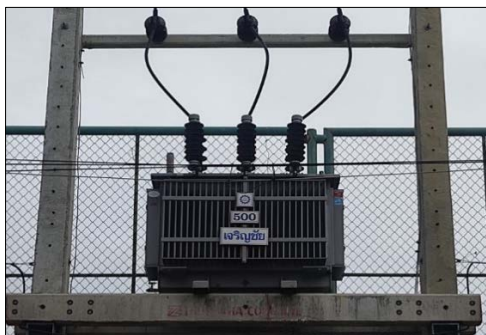
ภาพประกอบ 2-1 หม้อแปลงไฟฟ้าระบบจำหน่ายของการไฟฟ้าส่วนภูมิภาค
