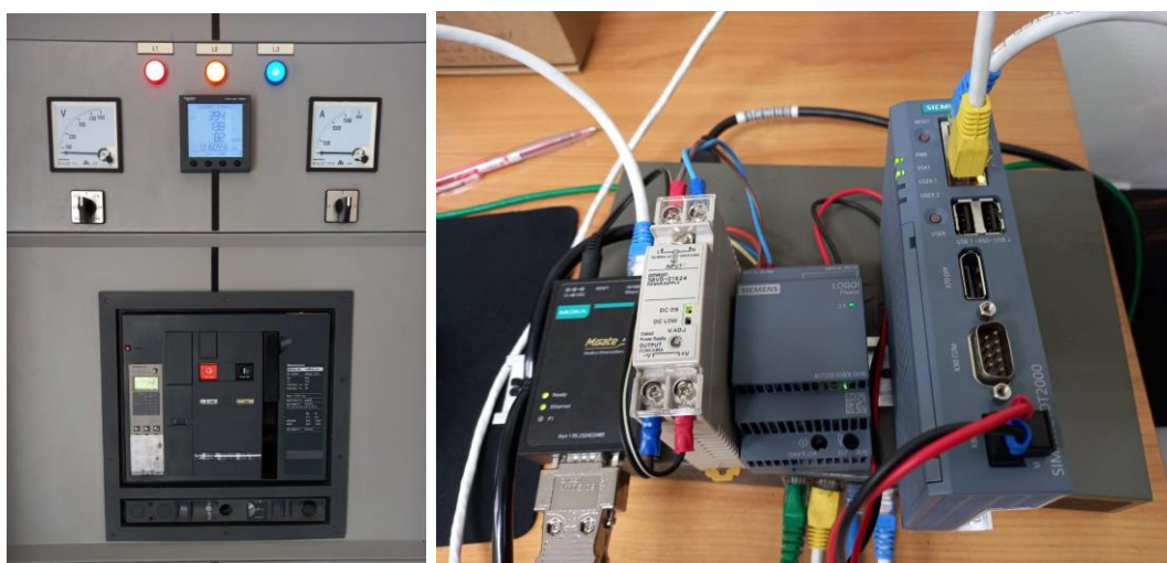
ภาพที่ 46 อุปกรณ์ระบบตรวจวัดการใช้พลังงานไฟฟ้า
