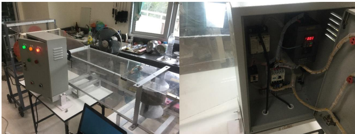
รูปที่ 3-29 เครื่องแปลงไฟสำหรับปรับความเร็วลมในอุโมงค์ลม
