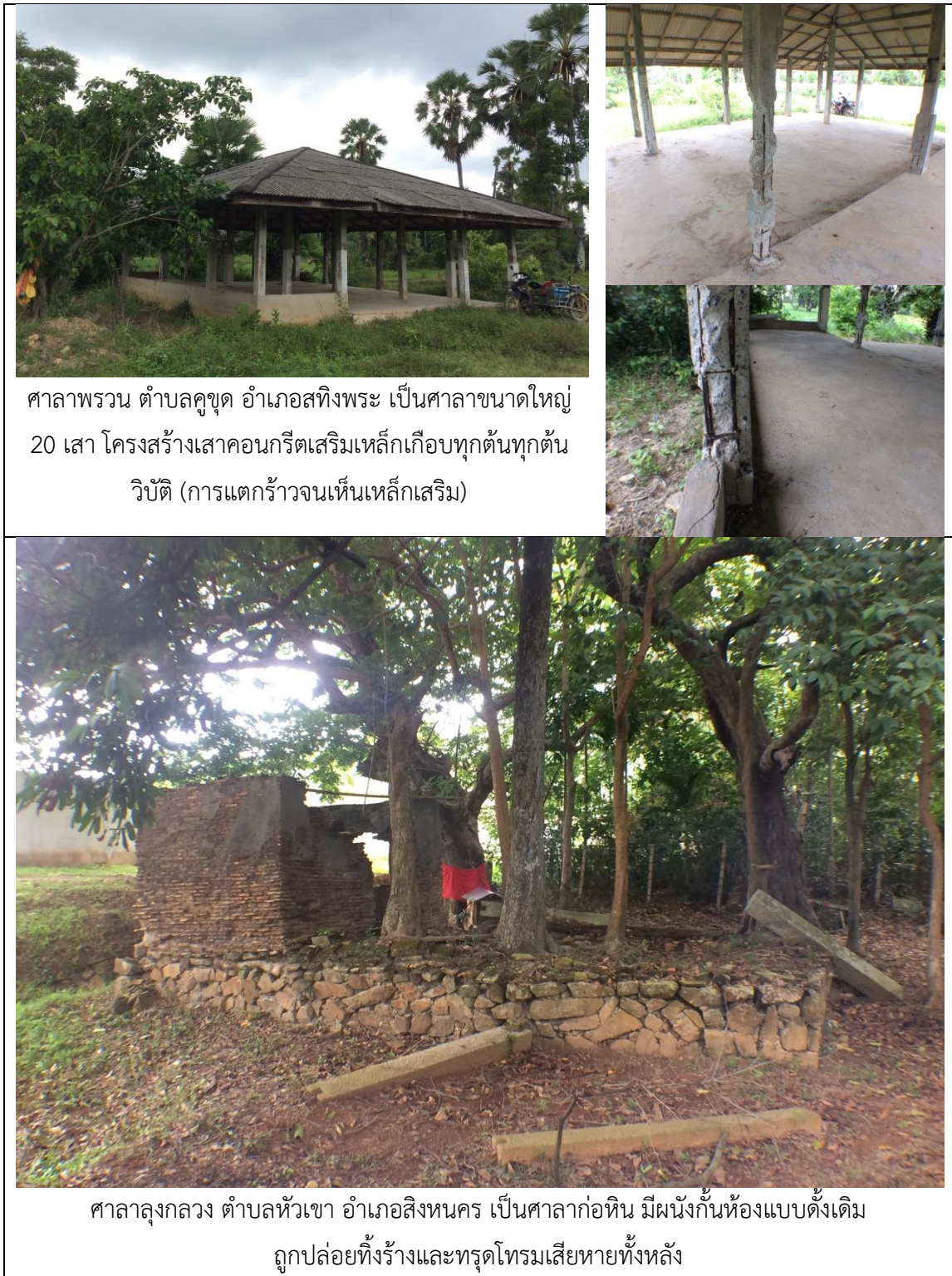
ภาพที่ 4.20 ลักษณะศาลากลางหนโครงสร้างก่อหินและอิฐดินเผาที่มีสภาพทรุดโทรม
