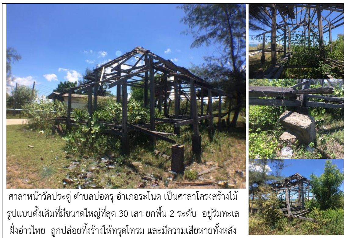
ภาพที่ 4.16 ลักษณะศาลากลางหนโครงสร้างไม้ที่มีสภาพทรุดโทรม
