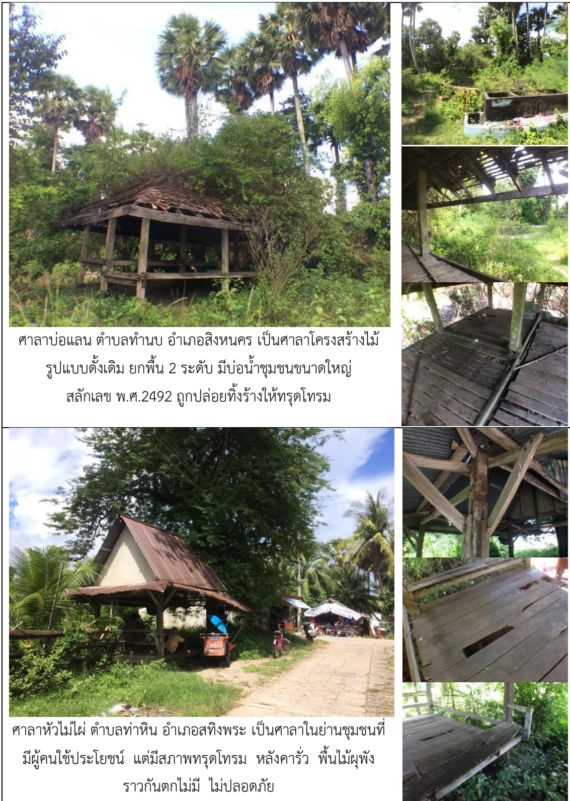
ภาพที่ 4.17 ลักษณะศาลากลางหนโครงสร้างไม้ที่มีสภาพทรุดโทรม
