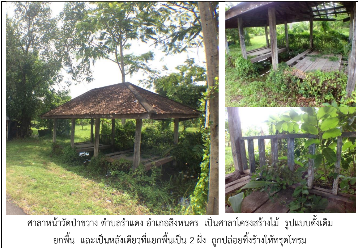
ภาพที่ 4.18 ลักษณะศาลากลางหนโครงสร้างไม้ที่มีสภาพทรุดโทรม
