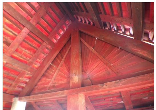
ลักษณะโครงสร้างหลังคาทรงจั่วศาลาแก้วบ่อ ตำบลชิงโค อำเภอสิงหนคร ได้รับการฟื้นฟูเมื่อ พ.ศ.2561 เป็นไม้ ทาสี ตามลักษณะเดิม
