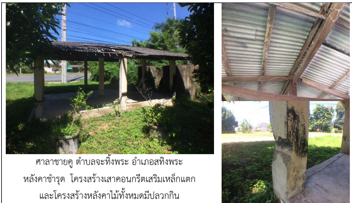
ภาพที่ 4.19 ลักษณะศาลากลางหนโครงสร้างคอนกรีตเสริมเหล็กที่มีสภาพทรุดโทรม
