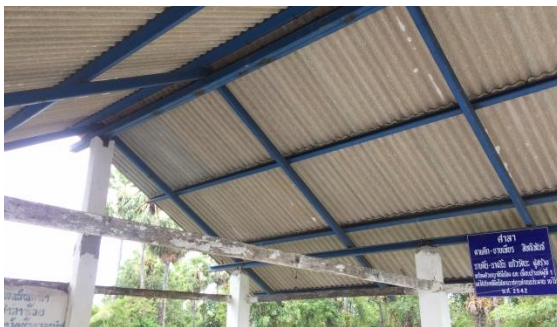
ลักษณะโครงสร้างหลังคาทรงจั่ว ศาลา ตาแค้กยายเพียร ตำบลป่าขาด อำเภอสิงหนคร มือไก่ จันทัน และแปเป็นเหล็ก
