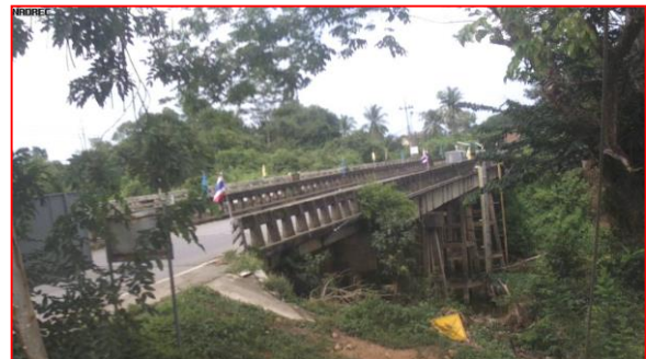
สถานีสะพานบ้านบางศาลา – ต.บ้านพรุ อ.หาดใหญ่ จ.สงขลา (ลุ่มน้ำทะเลสาบสงขลา)
