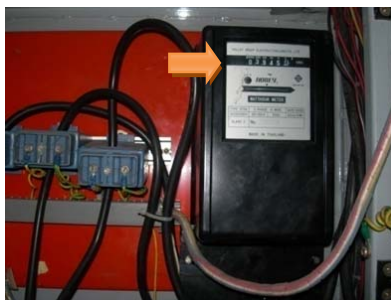
รูปที่ ๓.๔ ตัวอย่างการติดตั้งมิเตอร์ไฟฟ้าเฉพาะสำหรับระบบบำบัดน้ำเสีย
