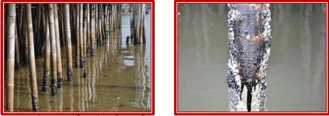
รูปที่ 43 คราบน้ำมันที่ปนเปื้อนในน้ำและเกาะติดบนเสาไม้ไผ่บริเวณปากคลองประมง
