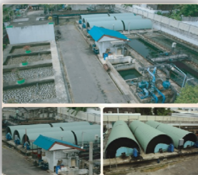
ระบบแผ่นหมุนชีวภาพ (Rotating Biological Contactor : RBC)
