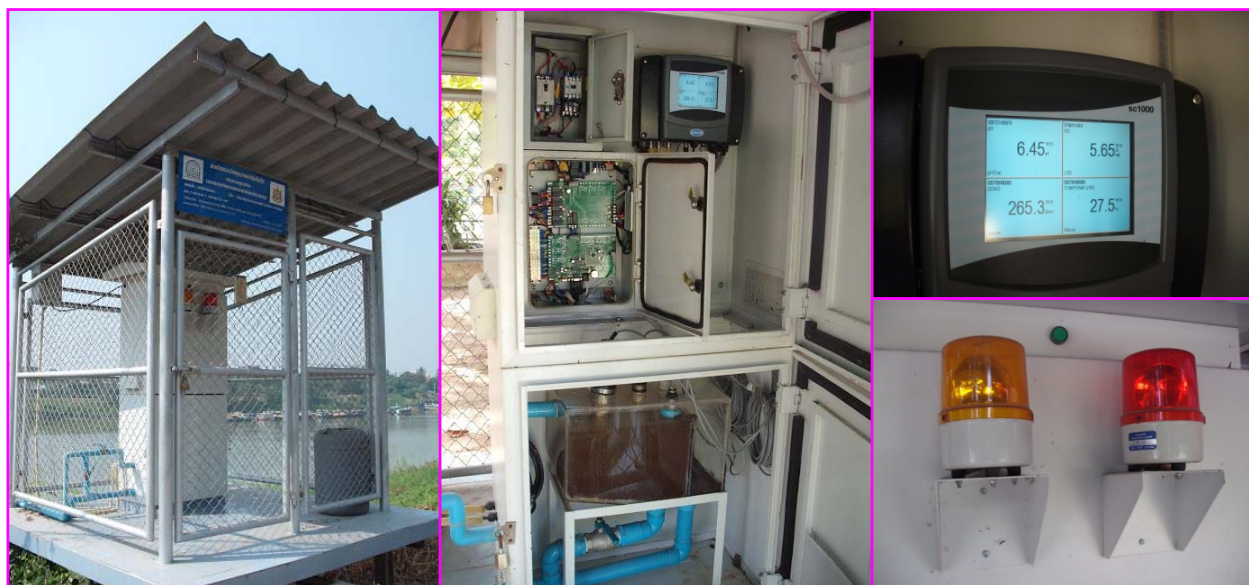
อาคารสถานีตรวจวัดคุณภาพน้ำอัตโนมัติและเครื่องมือตรวจวัดคุณภาพน้ำในปัจจุบัน
