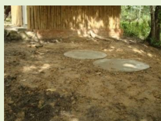
ระบบอดกรองไร้อากาศที่ก่อสร้างแล้วเสร็จ
