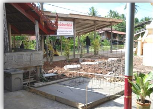
รูปแสดงการจัดสร้างระบบบำบัดน้ำเสียนาร่อง ณ วัดแจ้งเจริญ
