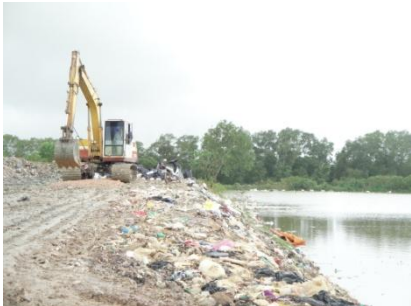
ระบบกำจัดขยะมูลฝอยแบบถูกหลักสุขาภิบาล เทศบาลเมืองพัทลุง
