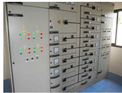
ห้องควบคุมระบบ
