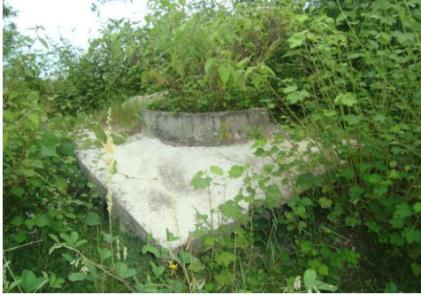
บ่อสังเกตการณ์
