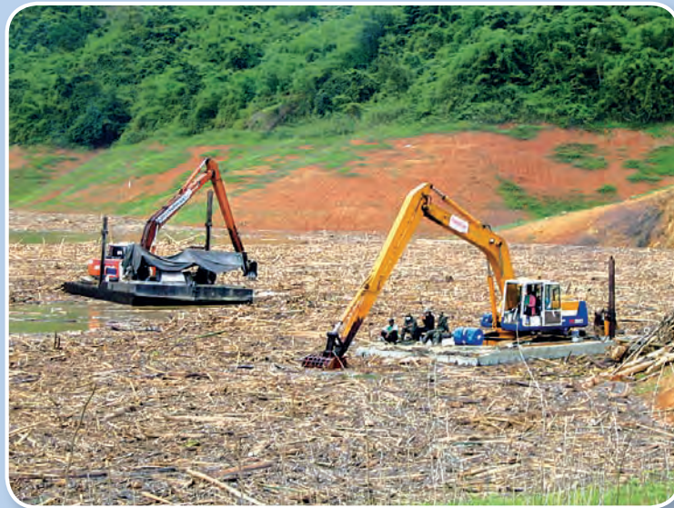
สำนักชลประทานที่ 3 ได้ให้การสนับสนุนเครื่องจักรเครื่องมือในการดำเนินงานเก็บกู้ซากปรักหักพังจากอุทกภัย แผ่นดินถล่ม
