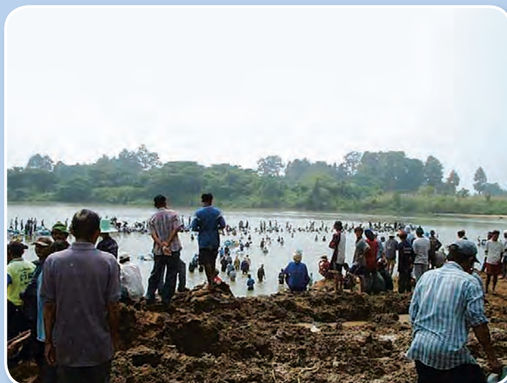
สำนักชลประทานที่ 4 ภาพแสดงเกษตรกรร่วมมือกันนำกระสอบทรายกั้นแม่น้ำปิง เพื่อทดน้ำเข้าโครงการวังยาง จ.กำแพงเพชร
