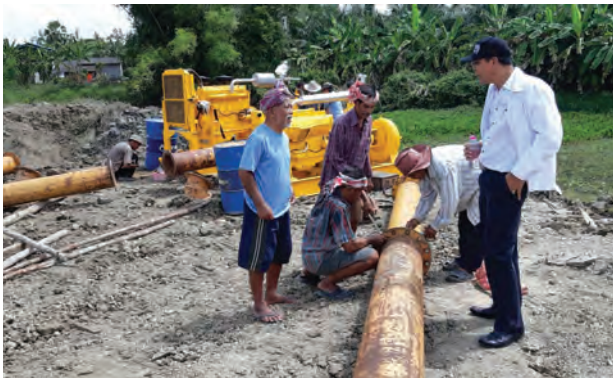
ติดตั้งเครื่องสูบน้ำเคลื่อนที่ ในช่วงฝนทิ้งช่วง จังหวัดนครศรีธรรมราช
