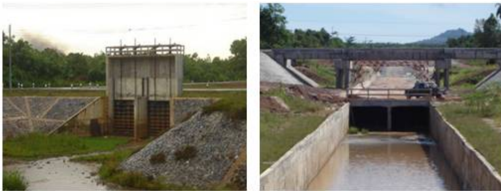
รูปที่ 8. คลองระบายน้ำ ร.6 พร้อมอาคารประกอบ
