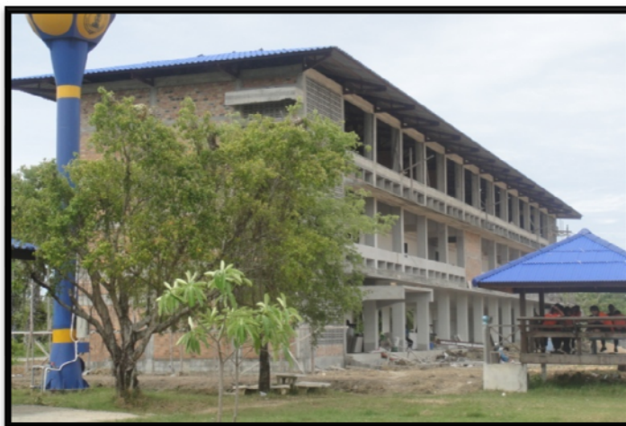
ภาพที่ 16 อาคารเรียนโรงเรียนสมเด็จพระเจ้าพะโคะ (มัธยม) งบก่อสร้างจากวัดพะโคะ ที่มา : ภาพถ่ายโดยผู้วิจัย 10 มิถุนายน 2555
