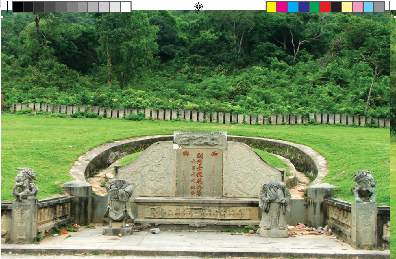
สุสานต้นตระกูล ณ สงขลา แปลงที่ 1 ความทรุดโทรมซึ่งเกิดจากการทำลายรูปสลักหินมีเห็นเด่นชัด
