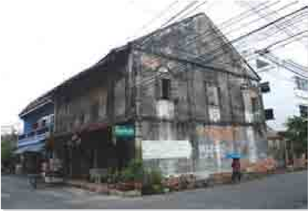
อาคารเก่าที่สุดหลังหนึ่ง บนถนนนางงาม อยู่ในสภาพทรุดโทรม
