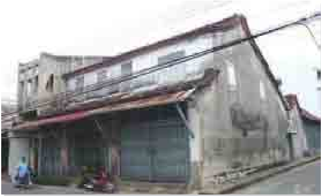
อาคารชิโน-โปรตุกีส ในยุคแรก บนถนนนครใน เมืองสงขลา อยู่ในสภาพทรุดโทรม จั่วหลังคาเป็นแบบเดียวกับที่พบเห็นได้ในจังหวัดปัตตานี และเกาะปឹងง ช่องโถงระหว่างส่วนหน้ากับส่วนหลังถูกปิดด้วยหลังคา และประตูด้านหน้าถูกเปลี่ยนเป็นประตูเหล็กแบบชักยึดได้ไปแล้ว
