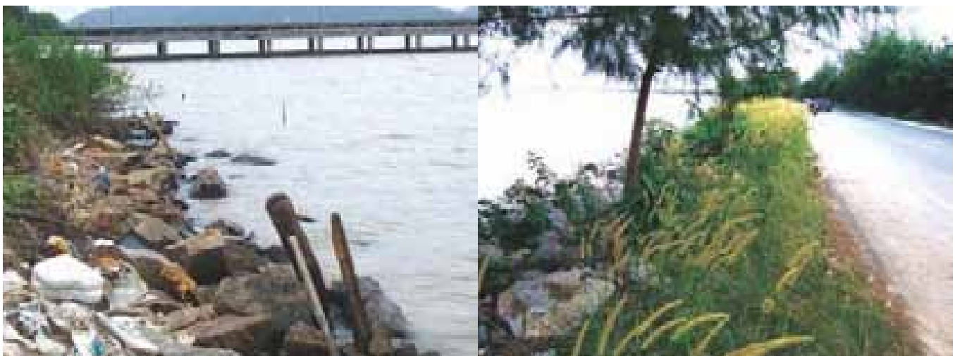
พื้นที่กัดเซาะชายฝั่ง บริเวณบ้านท่าสะพาน ตำบลเขารูปช้าง อำเภอเมืองสงขลา มีการก่อสร้างกำแพงกันคลื่นแบบหินทิ้งเพื่อป้องกันการกัดเซาะ
