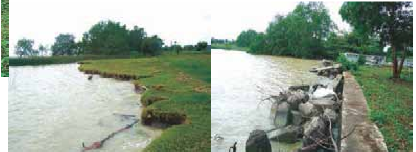
พื้นที่น้ำท่วมที่ถุกกัดเซาะบริเวณบ้านป่าขาด
