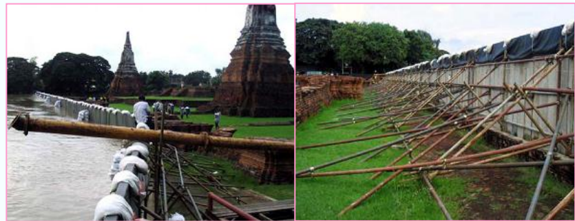
คันป้องกันน้ำท่วมแบบแผ่นคอนกรีตสำเร็จ วัดไชยวัฒนาราม จ.อยุธยา
