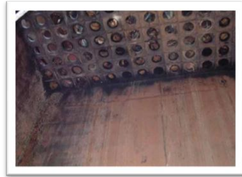
รูปที่ 1.8 แสดงถูกรองฝุ่นที่ถูกไฟไหม้
