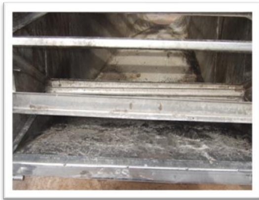
แสดงไฟไหม้ไส้กรองอากาศใต้ไซโคลนร้อน
