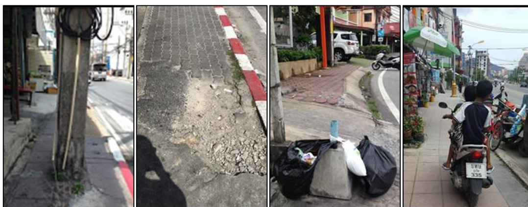
ก) สิ่งกีดขวางบนทางเท้า ข) ผิวทางเท้าชำรุด ค) ขยะบนทางเท้า ง) รถวิ่งบนทางเท้า
