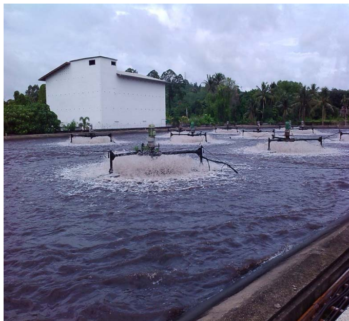
ภาพที่ 16 ระบบบำบัดน้ำเสีย SBR ของโรงงานยางแท่ง STR20 ที่ได้มีการนำตะกอนจุลินทรีย์ในระบบมาใช้ในการทดลอง
