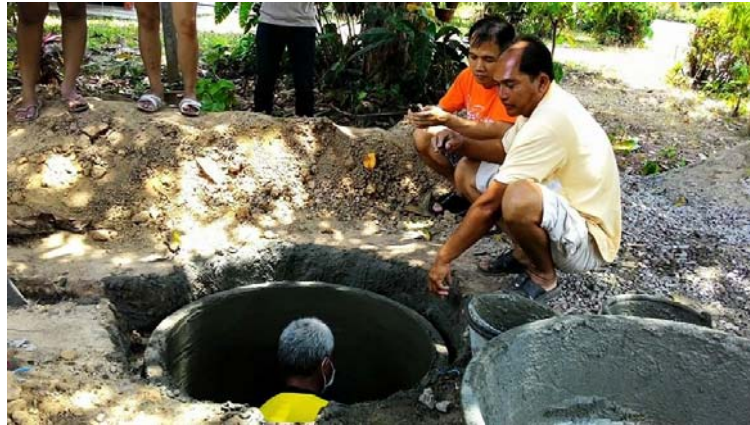
ง. การตกแต่งรอยฉาบปูนด้านในบ่อก๊าซชีวภาพ
