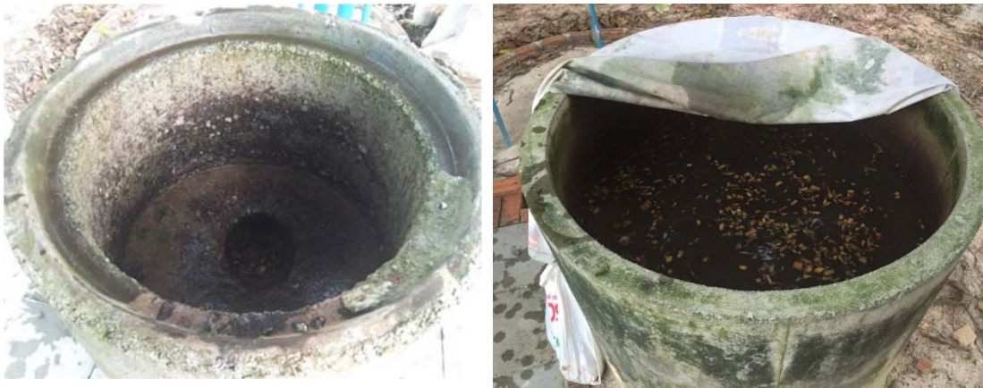
รูปที่ 4-11 เศษเปลือกกล้วยอัดตันตรงบ่อป้อน และหลุดออกบริเวณจุดระบายน้ำทิ้ง household biogas
