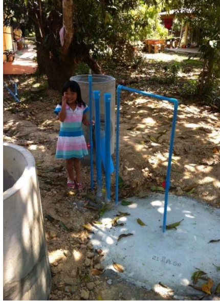
ช. ระบบผลิตก๊าซชีวภาพ Fixed dome ที่ก่อสร้างเสร็จแล้ว
