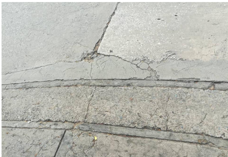
รูปที่ 2.1 รอยแตกบริเวณมุมของถนนคอนกรีต ที่มา : ผู้วิจัย
