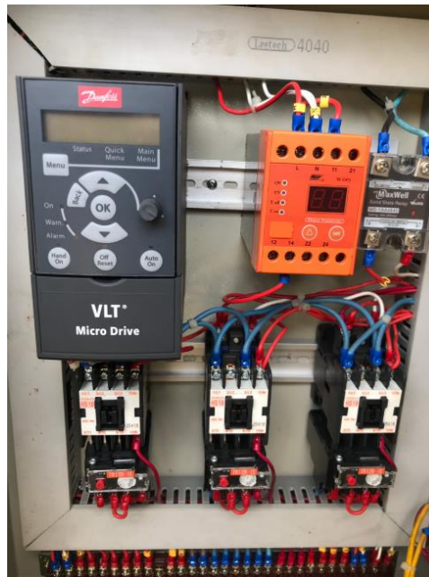
รูปที่ 4.22 แผงควบคุมการทำงานระบบไฟฟ้า ตู้อบลมร้อน
