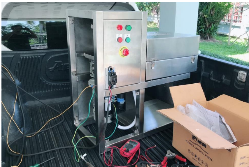
รูปที่ 4.5 ชุดสวิตช์ควบคุมการทำงาน
