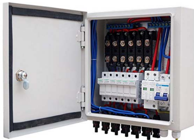
รูปที่ 4.6 ชุด Combiner Box เพื่อเพิ่มกำลังไฟฟ้าของแผงโซลาร์เซลล์
