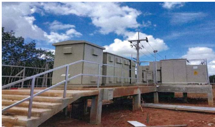
รูปที่ 4.11 สถานีควบคุมการจ่ายไฟฟ้า (Transformer Substation)
