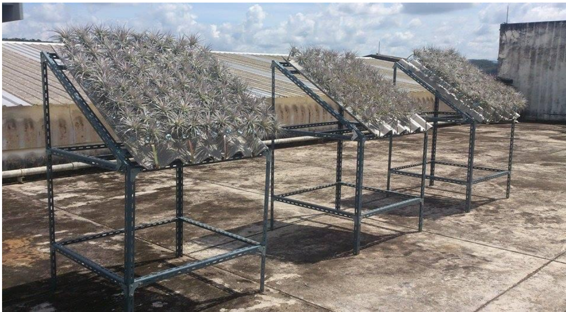
ภาพที่ 2-30 การติดตั้งแผงอุปกรณ์ปลูกพืชอากาศบนหลังคากระเบื้องลอนคู่
