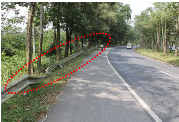
4) ราวกันอันตรายชำรุดจากการชนโดยไม่ได้ทำการซ่อมแซมให้กลับสู่สภาพเดิม
