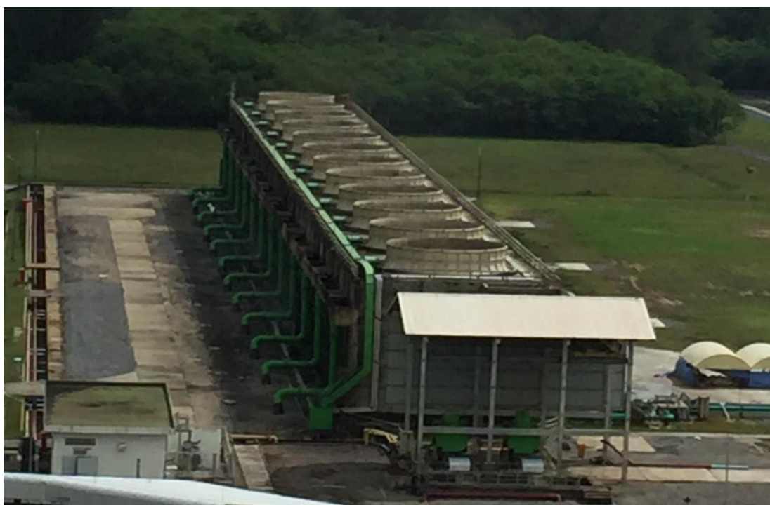
ภาพที่ 4.64 Cooling tower
