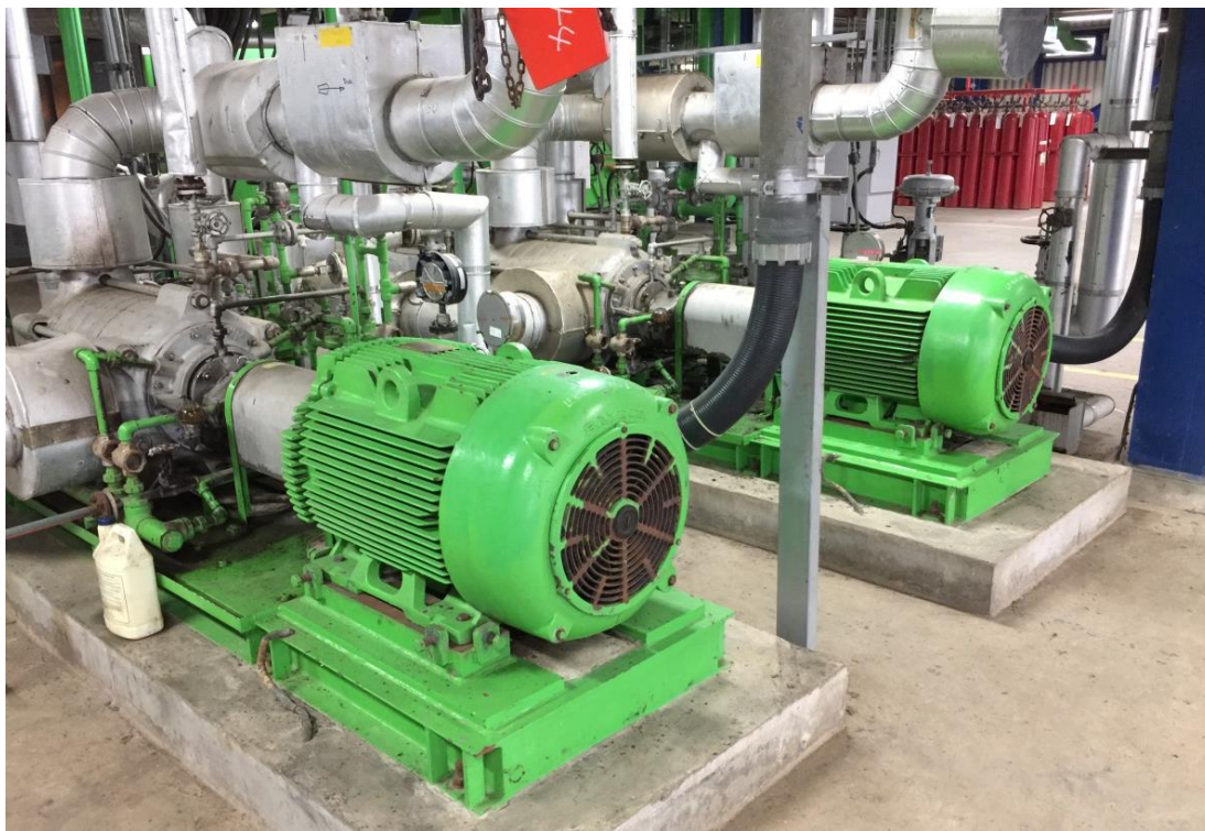
ภาพที่ 4.72 LP heater drain pump
