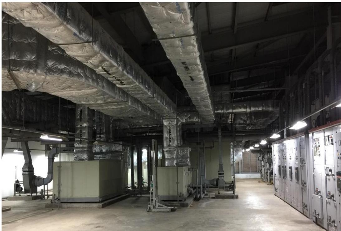
ภาพที่ 4.76 ระบบปรับอากาศ HVAC
