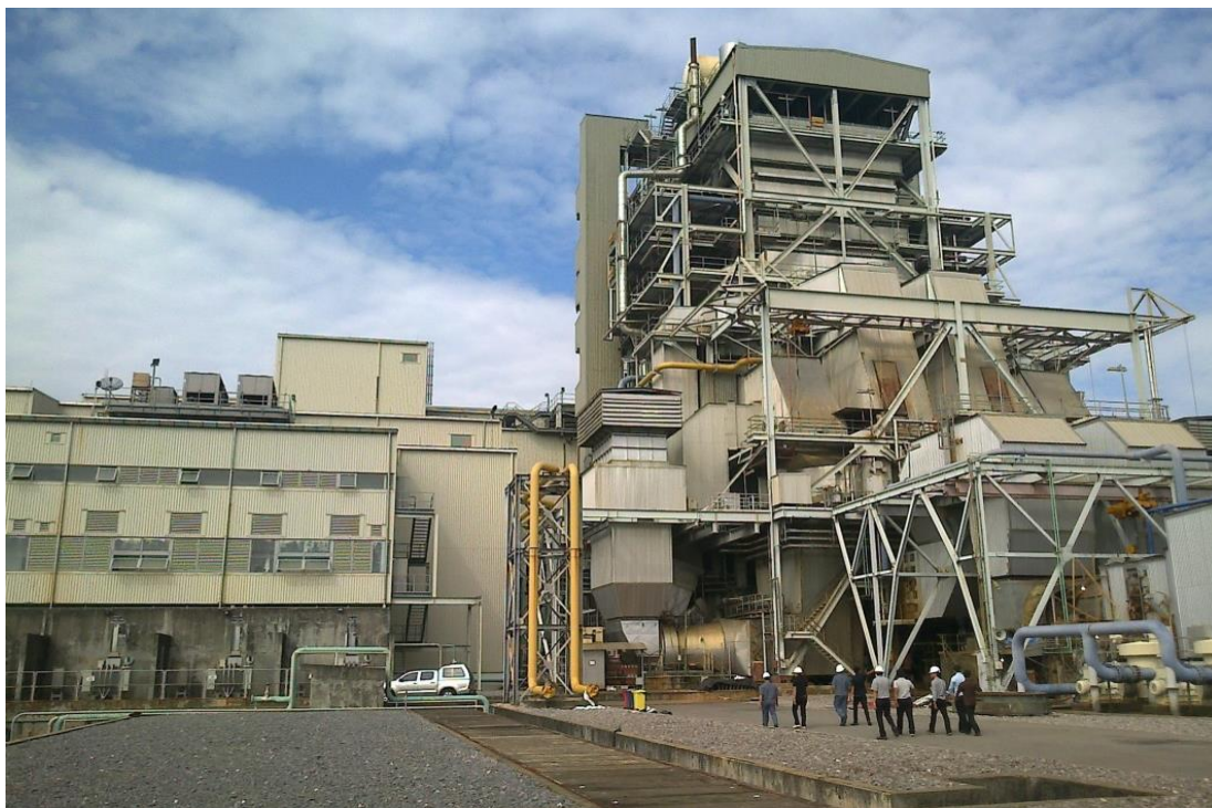
ภาพที่ 4.91 หม้อไอน้ำและ Air Heater
