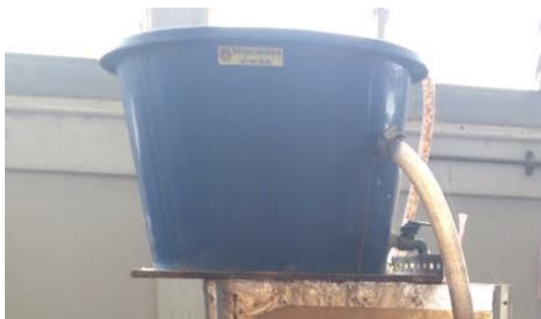
รูปที่ 2.13 ถังเติมอากาศ
