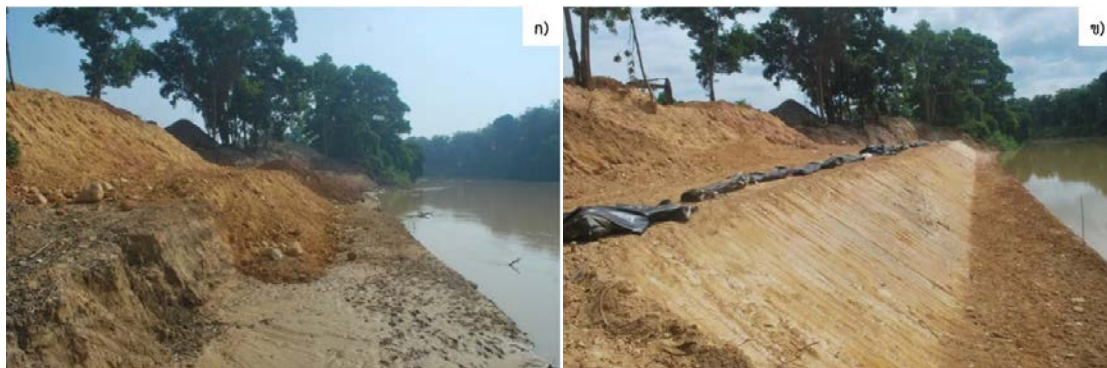
รูปที่ 5.17 การถมดินเพื่อปรับระดับของตลิ่งในชั้นล่าง ก) แนวตลิ่งก่อนเริ่มทำการถมดินปรับระดับ ข) แนวตลิ่งหลังจากการถมดินปรับระดับจากตีนตลิ่งถึงระดับความสูง 2.5 เมตร
