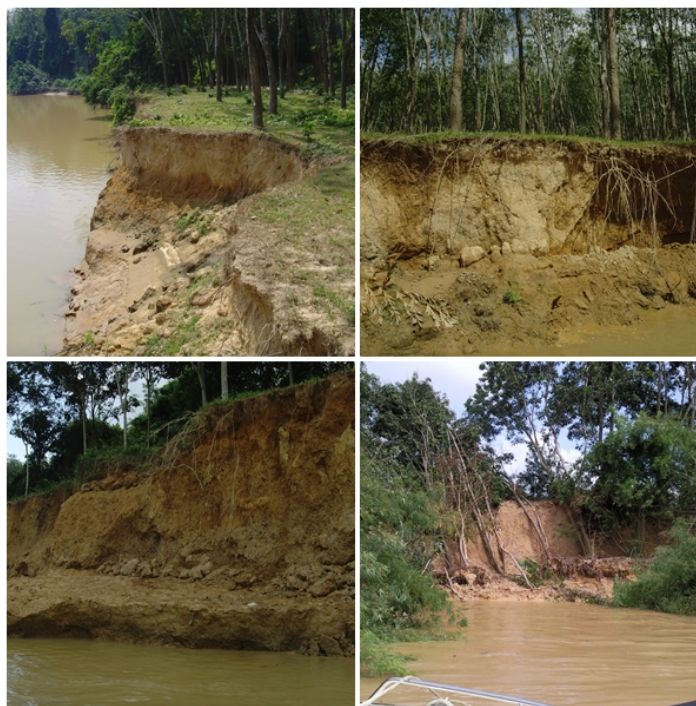
รูปที่ 5.2 ลักษณะของตลิ่งคลองอุตะเถาในปี 2552 บริเวณที่ห่างจากหลังประตูระบายน้ำคลองอุตะเถา ประมาณ 3-10 กิโลเมตรตามแนวคลอง
