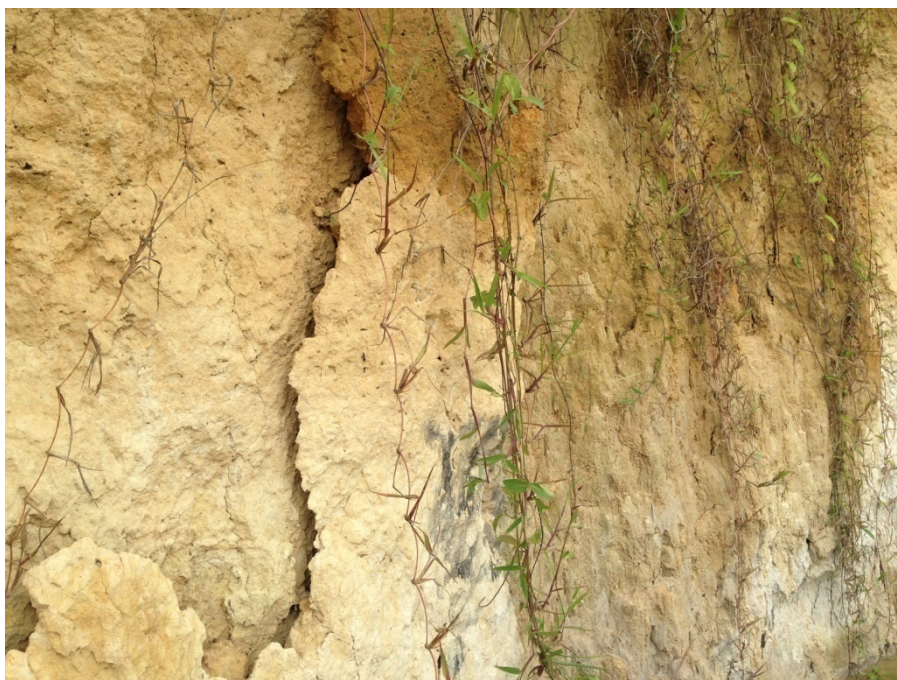
รูปที่ 2.8 รอยแตกบริเวณผิวของริมตลิ่ง (ภาพถ่ายโดย สุรติ เสมอหมัด 2555)
