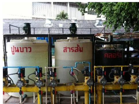
ภาพประกอบ 2-6 จุดจ่ายสารเคมีไปยังถังตกตะกอน
