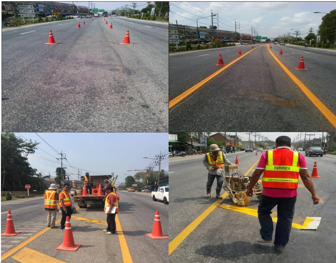
รูปที่ 4-33 ชีตสีตีเส้นจราจรเพื่อแบ่งทิศทางจราจร
