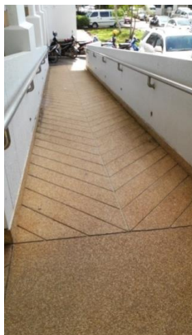
ภาพประกอบ 4.32 ทางลาดสำหรับผู้สูงวัยบริเวณส่วนราชการจังหวัดสุราษฎร์ธานี
