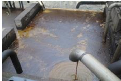
ภาพประกอบที่ 2-7 บ่อดักน้ำมันของน้ำเสียจากหม้อนึ่ง ที่มา: บริษัทพิทักษ์ปาล์มออยล์ จำกัด
