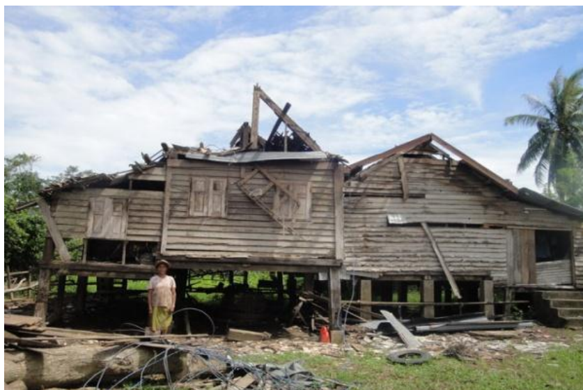
ภาพที่ 13 สภาพบ้านเรือนที่ได้รับความเสียหายจากแรงพายุ ที่มา: สามารถ สุขบรรจง, 2554.
