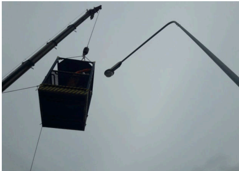
รูปที่ 3.10 การใช้รถเครนในการเปลี่ยนโคมไฟถนน LED (Street light) ขนาด 122 วัตต์
