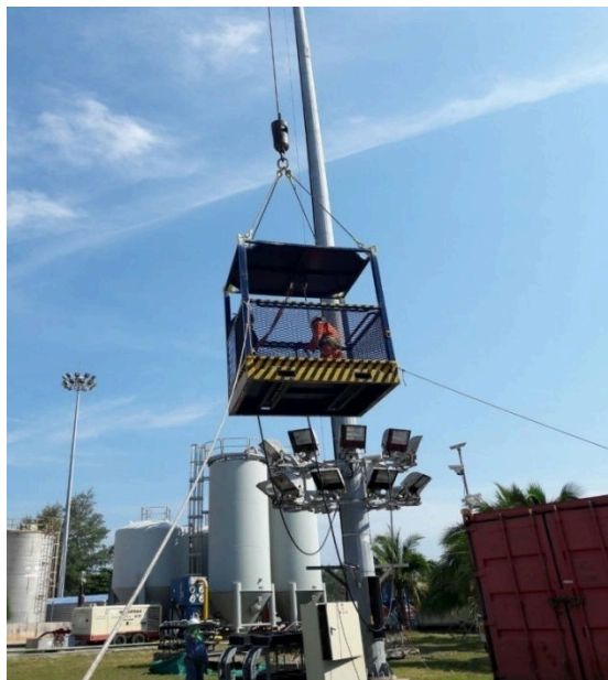
รูปที่ 3.25 การใช้รถเข็นนำตะกร้ายกคนลงเพื่อถอดเปลี่ยนโคมไฟ
