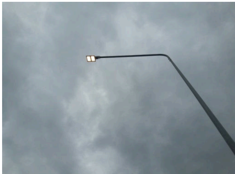
รูปที่ 3.12 การทดสอบโคมไฟถนน LED (Street light) ขนาด 122 วัตต์
