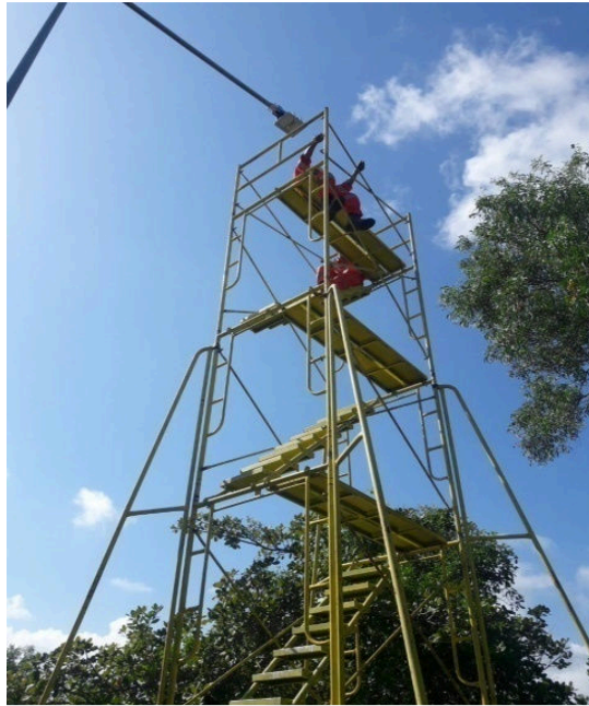
รูปที่ 3.11 การใช้นั่งร้านในการเปลี่ยนโคมไฟ LED (Street light) ขนาด 122 วัตต์
