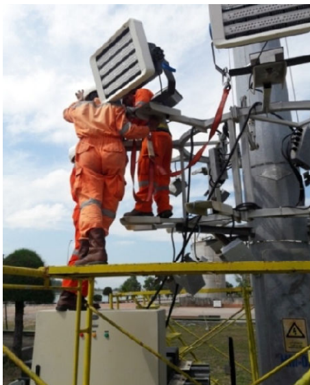
รูปที่ 3.31 การใช้นั่งร้านติดตั้งโคมไฟ LED ขนาด 640 วัตต์
