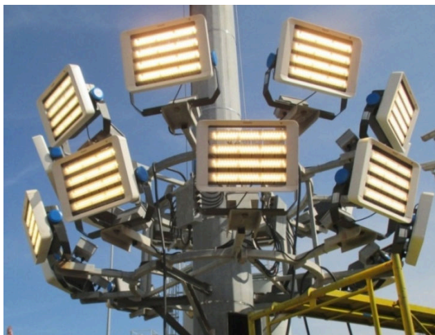
รูปที่ 3.32 การทดสอบโคมไฟเสาส่งไฟฟ้าแรงสูง LED (High mast) ขนาด 640 วัตต์
