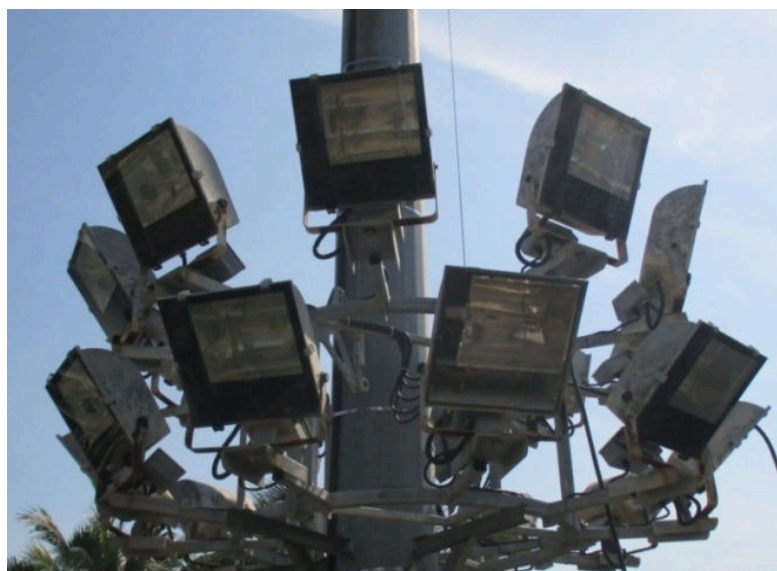
รูปที่ 3.26 โคมไฟเสาสูงไฟฟ้าแรงสูง (High mast) จำนวน 20 โคม
