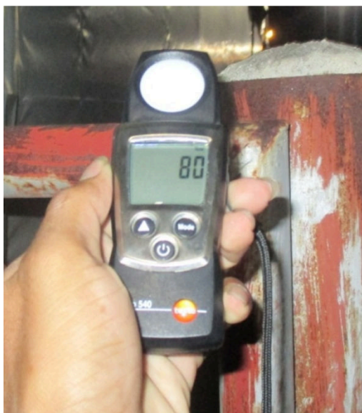
รูปที่ 3.21 การวัดค่าแสงสว่างโคมไฟส่องสนาม LED (Flood light) ขนาด 200 วัตต์
