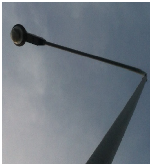
รูปที่ 3.5 โคมไฟถนน (Street light) ของเดิมใช้โคมไฟเมทัลฮาไลด์ ขนาด 250 วัตต์
