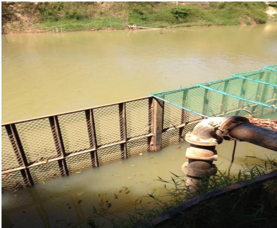
รูปที่ 3-3 จุดสูบน้ำดิบประปาพะตง-พังลา
