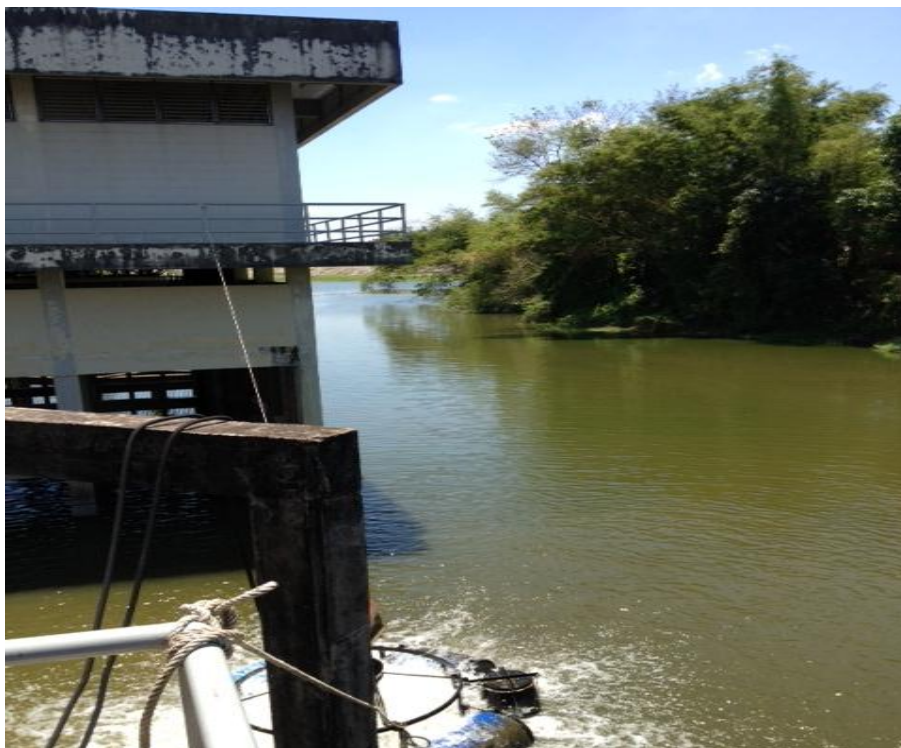
รูปที่ 3-5 จุดสูบน้ำดิบประปาขนาดใหญ่
