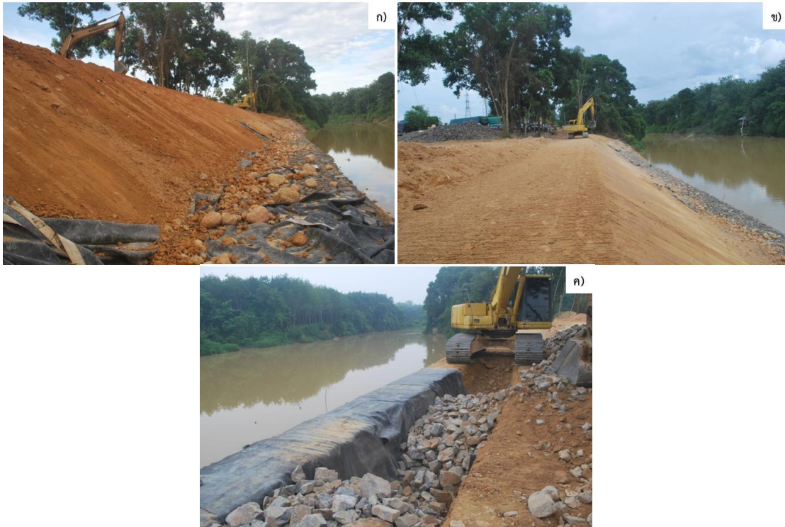
รูปที่ 5.19 การก่อสร้างแปลงสาธิตในช่วงระดับ 2.50-5.00 เมตร ก) การถมดินปรับระดับตลิ่งถึงระดับ 5.0 เมตร ข) แนวตลิ่งหลังจากปรับความชัน ค) การขุดร่องฝังแผ่นยางและเรียงหินบนตลิ่ง
