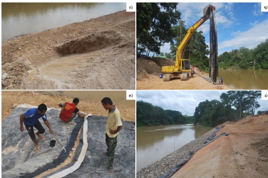
รูปที่ 5.18 การก่อสร้างแปลงสาธิตในช่วงระดับตีนตลิ่งถึงระดับ +2.50 เมตร ก) ร่องทางเข้า-ออกแปลงสาธิต ข) การเคลื่อนย้ายแผ่นยางเพื่อปูตลิ่ง ค) การทากาวยางบริเวณรอยต่อ ง) แนวตลิ่งหลังจากการปูยางและเรียงหินแล้ว
